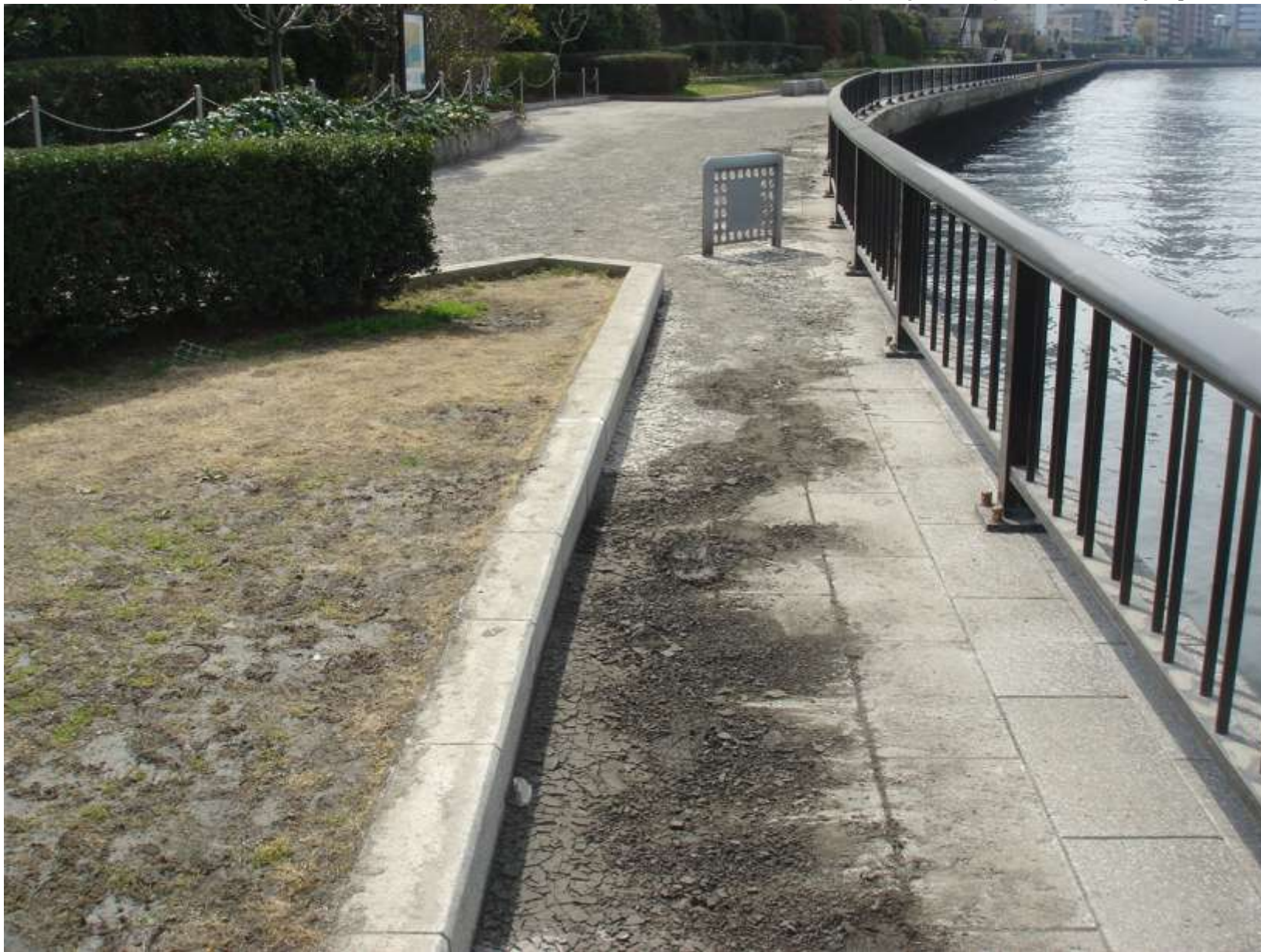
隅田川(測定地点1付近)の津波による土砂堆積
