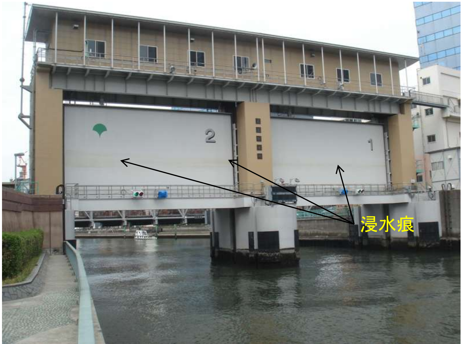
水門閉鎖時の津波によると思われる浸水痕(亀島川水門)
