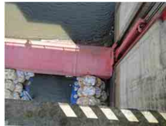
ゲート下流での漏水
