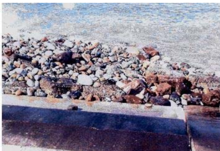
【⑧緩傾斜護岸の根固ブロックが飛散した例】平成16年2月23日 魚津
