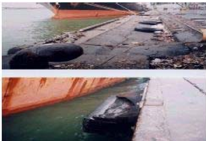
【⑪岸壁の防舷材が破損した例】平成 16 年 10 月 20 日 伏木富山 中央 1 号岸壁 (寄り回り波ではないが、伏木富山において既往最大波高発生)
