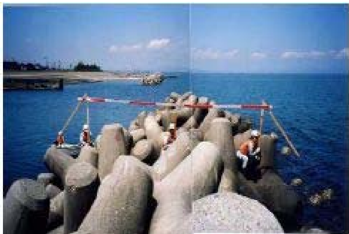
【⑨離岸堤の消波ブロックが散乱、沈下した例】平成9年1月6日 四方
