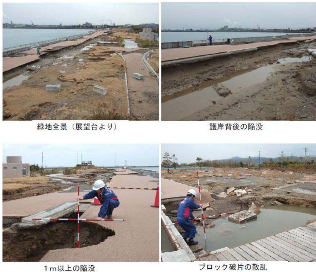
図 2-7 万葉埠頭緑地の被災状況
