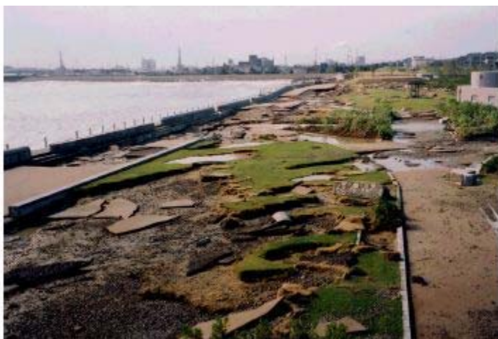
【⑫公園緑地が被災した例】平成 16 年 10 月 20 日 伏木富山 万葉ふ頭緑地 (寄り回り波ではないが、伏木富山において既往最大波高発生)
