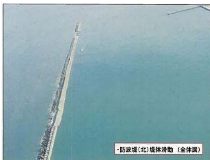
図 2-2 北防波堤の被災状況（全体図）
