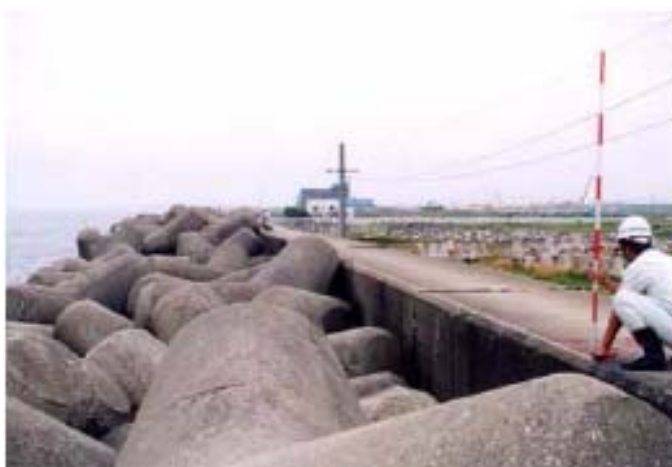
【⑤護岸消波工の消波ブロックの沈下例②】 平成 9 年 1 月 6 日 新湊
