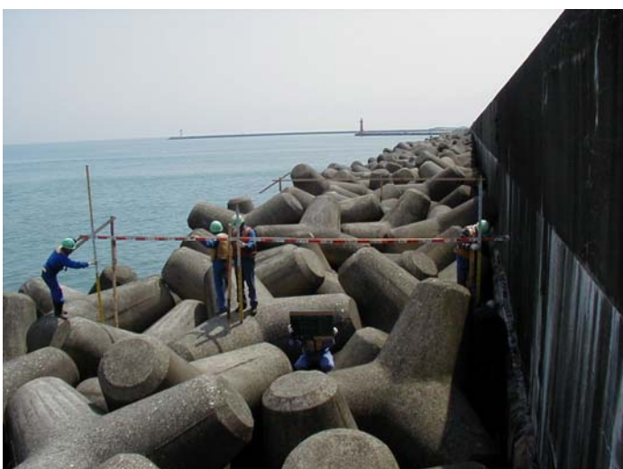
【⑥護岸消波工の消波ブロックの沈下例③】 平成 16 年 2 月 22 日 新湊
